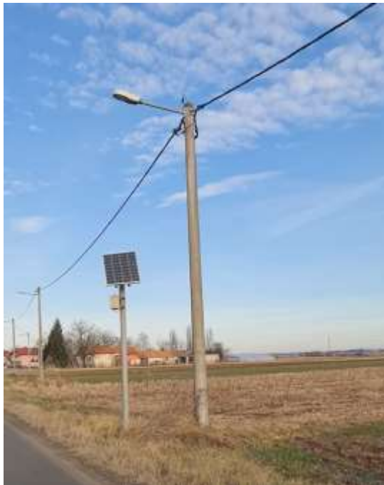
Slika 1 – postojeća rasvjetna tijela javne rasvjete
